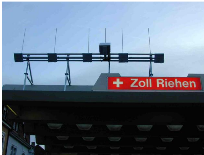
DSRC-Bakenanlage auf dem Dach einer Zollstelle
